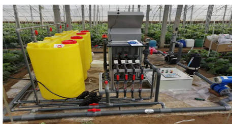
图2 智能水肥一体化技术装备
